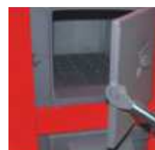
Camera di combustione
